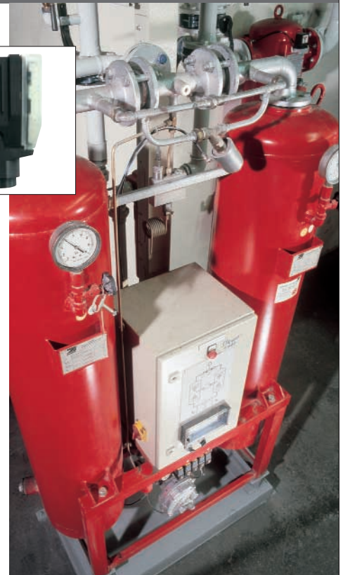
Bei Adsorptionstrocknern überwacht der testo 6740 nicht nur höchst zuverlässig die Restfeuchte, darüber hinaus dient er der optimalen Regelung – geringere Betriebskosten sind die Folge.
