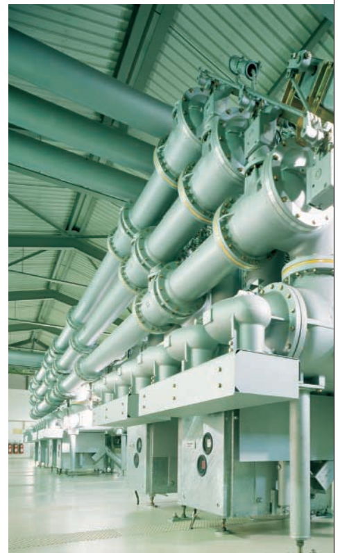
In der Hoch- und Mittelspannung dient \text{SF}_6 zur Vermeidung von Schaltfunken. testo 6740 überwacht kontinuierlich die Feuchte – so können die Austauschzyklen des teuren Gases maximiert werden; Schäden werden vermieden.
